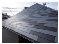
石綿スレート屋根材
